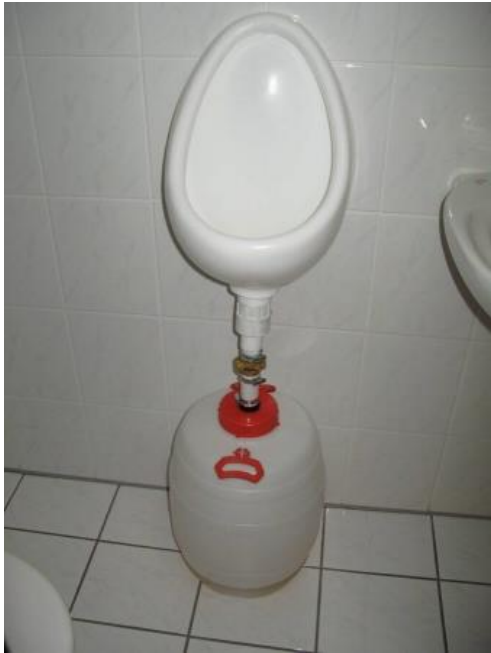
Urinoir aménagé pour la récupération
